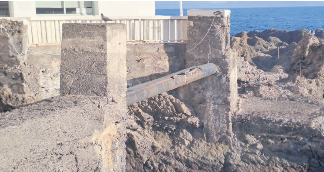
LA EXPOSICIÓN PERMANENTE AL ENTORNO MARINO HA PROVOCADO UN IMPORTANTE PROCESO DE CORROSIÓN DEL COLECTOR DE PUNTA BRAVA. DA
