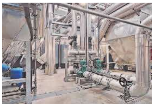
Canalizaciones de una central de calor.
