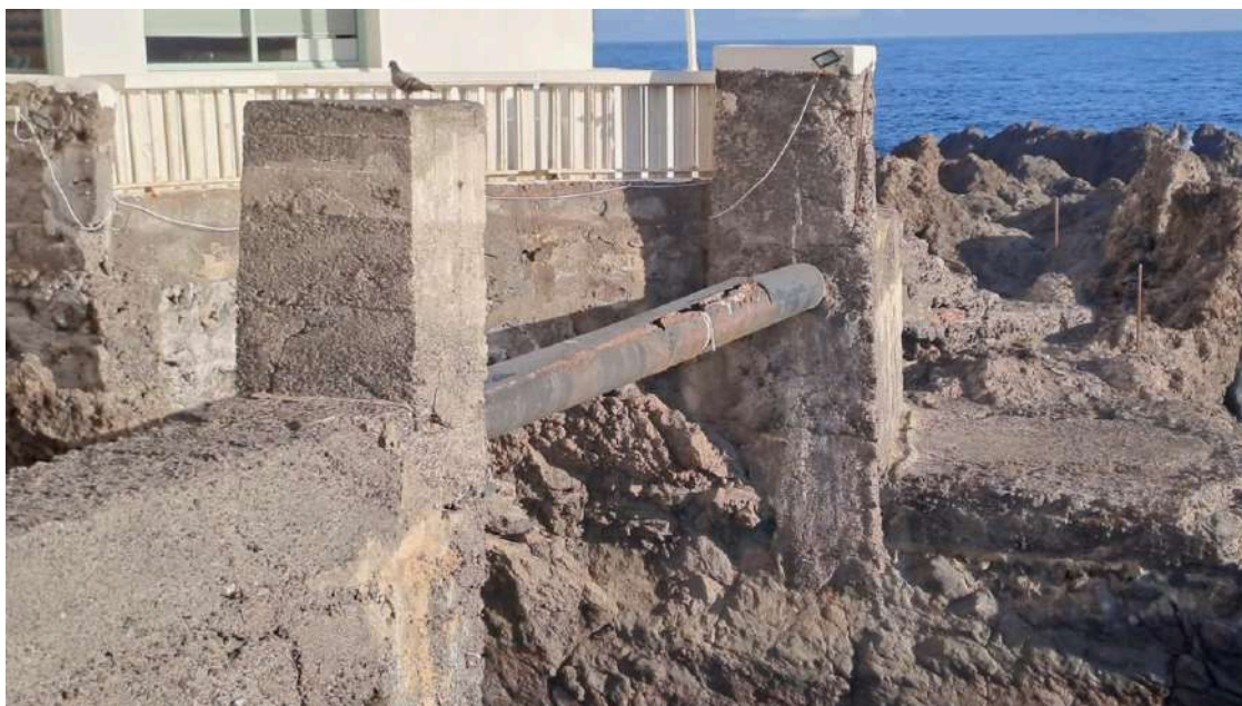
Colector de saneamiento deteriorado en Punta Brava, en Puerto de la Cruz. | DA
